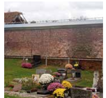
▲ De gemeente plaatste een spandoek met een foto van de muur voor het ingestorte gedeelte, maar dat is slechts een tijdelijke oplossing.
